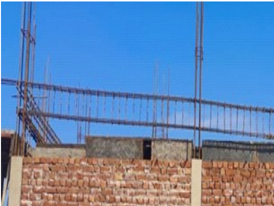
चित्र 18 : पंचकुला में निर्माणाधीन भवन (बीम में डकटाइल डिटेलिंग नहीं है और कॉलम का आकार आवश्यक से कम है)
