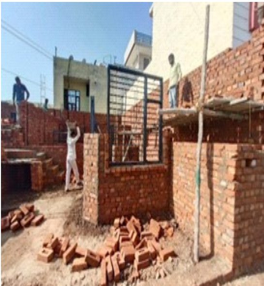
चित्र 22 : मोहाली में एक चिनाई भवन में सिल्ल स्तर के नीचे आरसीसी (RCC) बैंड नहीं दिया गया है।
